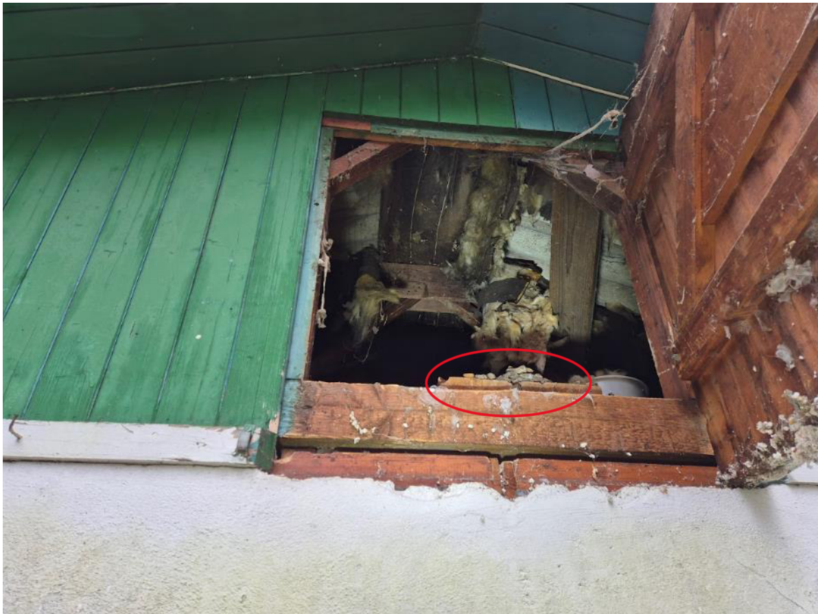
Abbildung 12: Blick in den Dachstuhl des mittleren Gebäudes mit den Zerstörungen durch den Marder sowie seinen Kotspreuen (roter Kreis)
