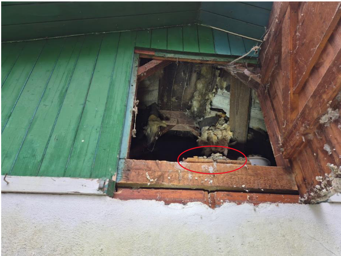
Abbildung 24: Blick in den Dachstuhl des mittleren Gebäudes mit den Zerstörungen durch den Marder sowie seinen Kotschnecken (roter Kreis)
