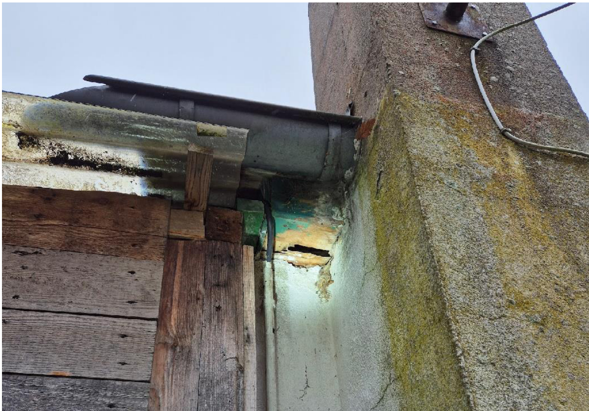
Abbildung 25: Blick auf einen Spalt in der Verkleidung des vom Eingriff betroffenen nördlichen Gebäudes in Eingriffsfläche 1
