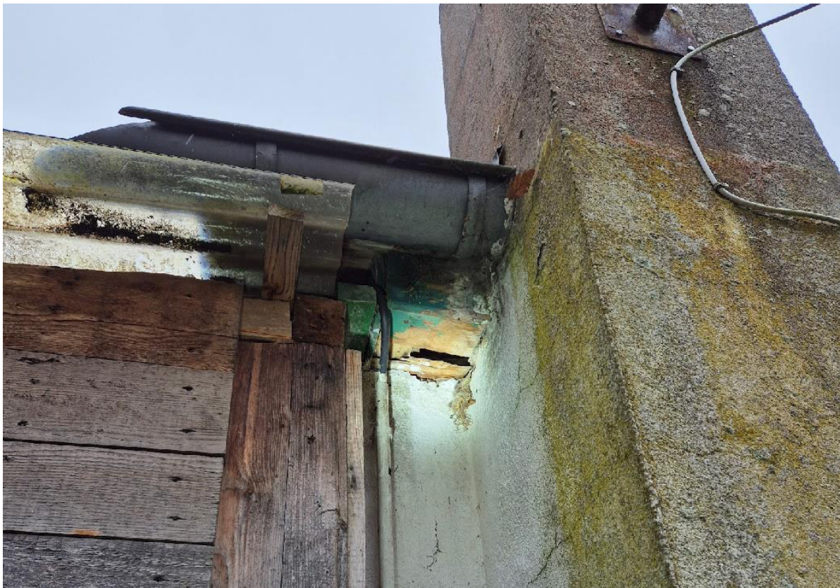
Abbildung 13: Blick auf einen Spalt in der Verkleidung des vom Eingriff betroffenen nördlichen Gebäudes in Eingriffsfläche 1
