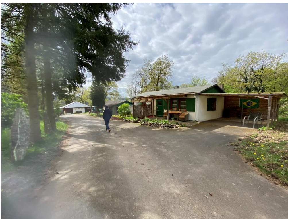
Abb. 12 Renovierungsbedürftige Mitarbeitergebäude im Bereich des SO3
