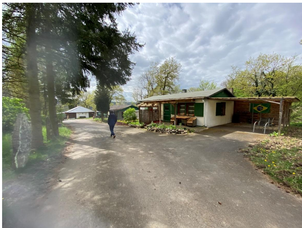
Abb. 12 Renovierungsbedürftige Mitarbeitergebäude im Bereich des SO3
